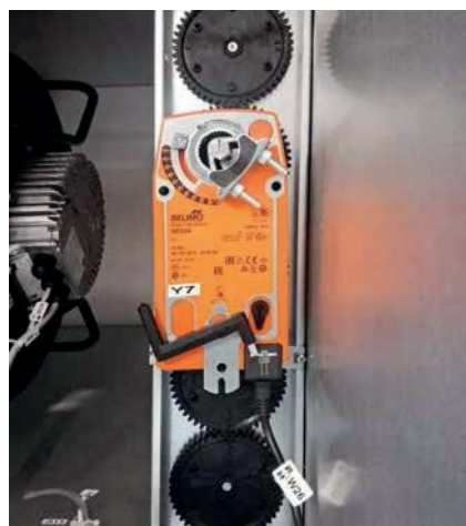
Slika 54: Pogon loput za sveži in odvodni zrak.
