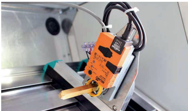
Slika 55: Pogon lopute ploščnega rekuperatorja.
