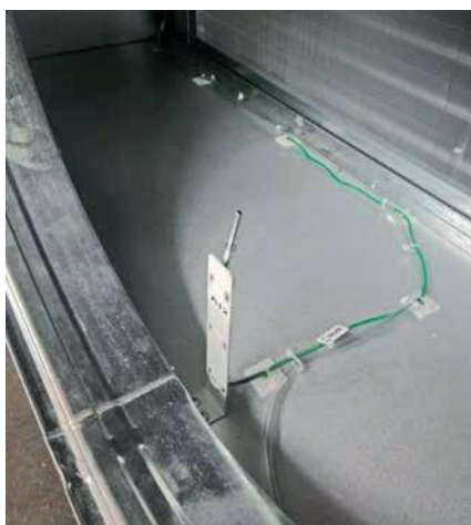
Slika 52: Tipalo temperature dovodnega zraka. Priključi se v priključni dozi, ki se nahaja za dovodnim ventilatorjem (zeleni konektor – gl. Slika 53).
